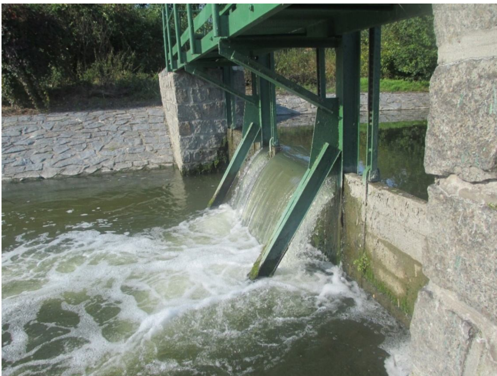
Obr. 31 První velké stavidlo s ovládáním v horní části (lávka pro obsluhu) postavené na okraji části Lány před železničním viaduktem s kamennými zídkami a částí koryta nad a pod stavidlem
