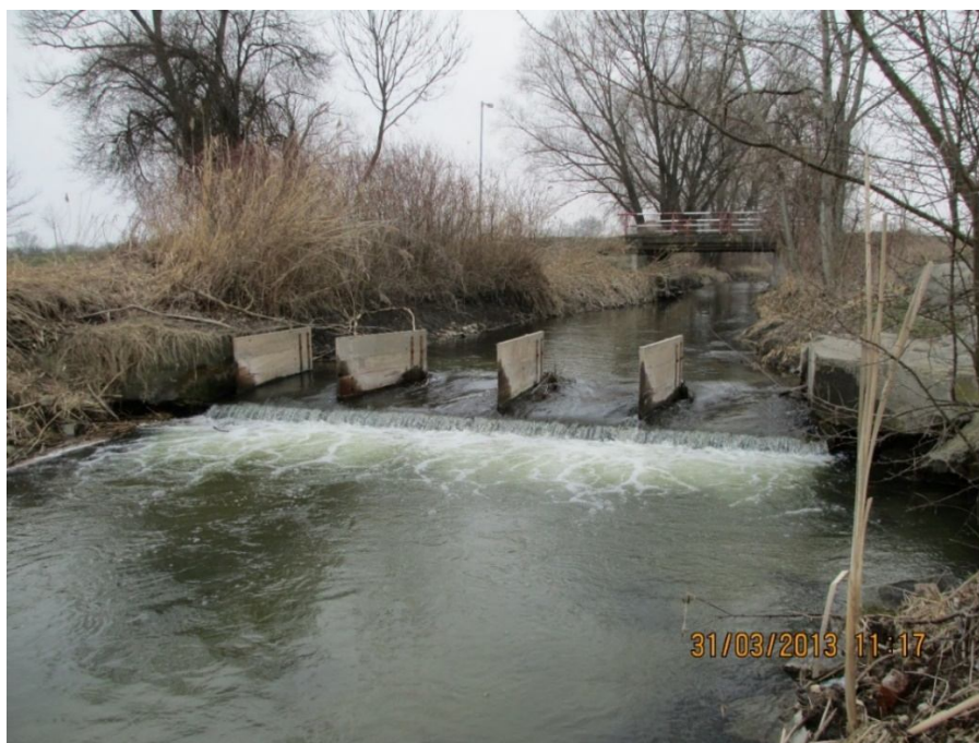
Obr. 30 Otevřené malé stavidlo pod obcí Hronětice, NB
