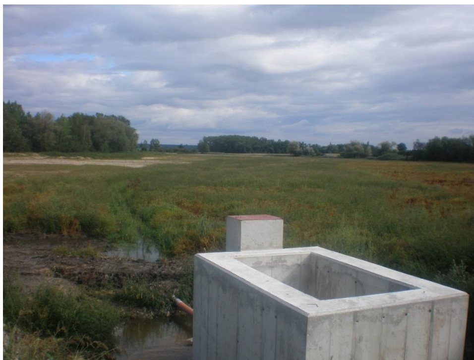
Obr. 44 Oprava výpustného zařízení a hráze Kosořického rybníka u Kosořic proběhla v roce 2012
