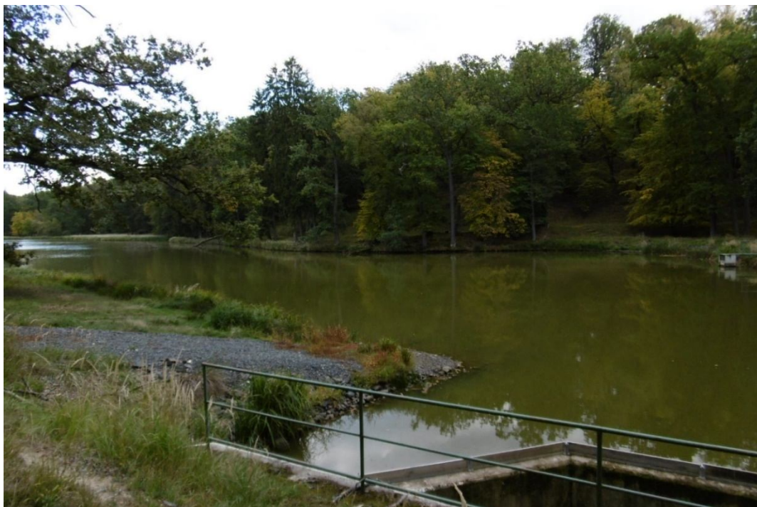
Obr. 43 Hrádecký rybník v Jabkenické oboře, vpravo dole část bezpečnostního přelivu, vpravo v pozadí stavidlo
