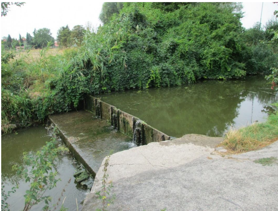
Obr. 87 Stav Vlkavy na stavidle Hronětice, NB, dne 16. srpna 2015
